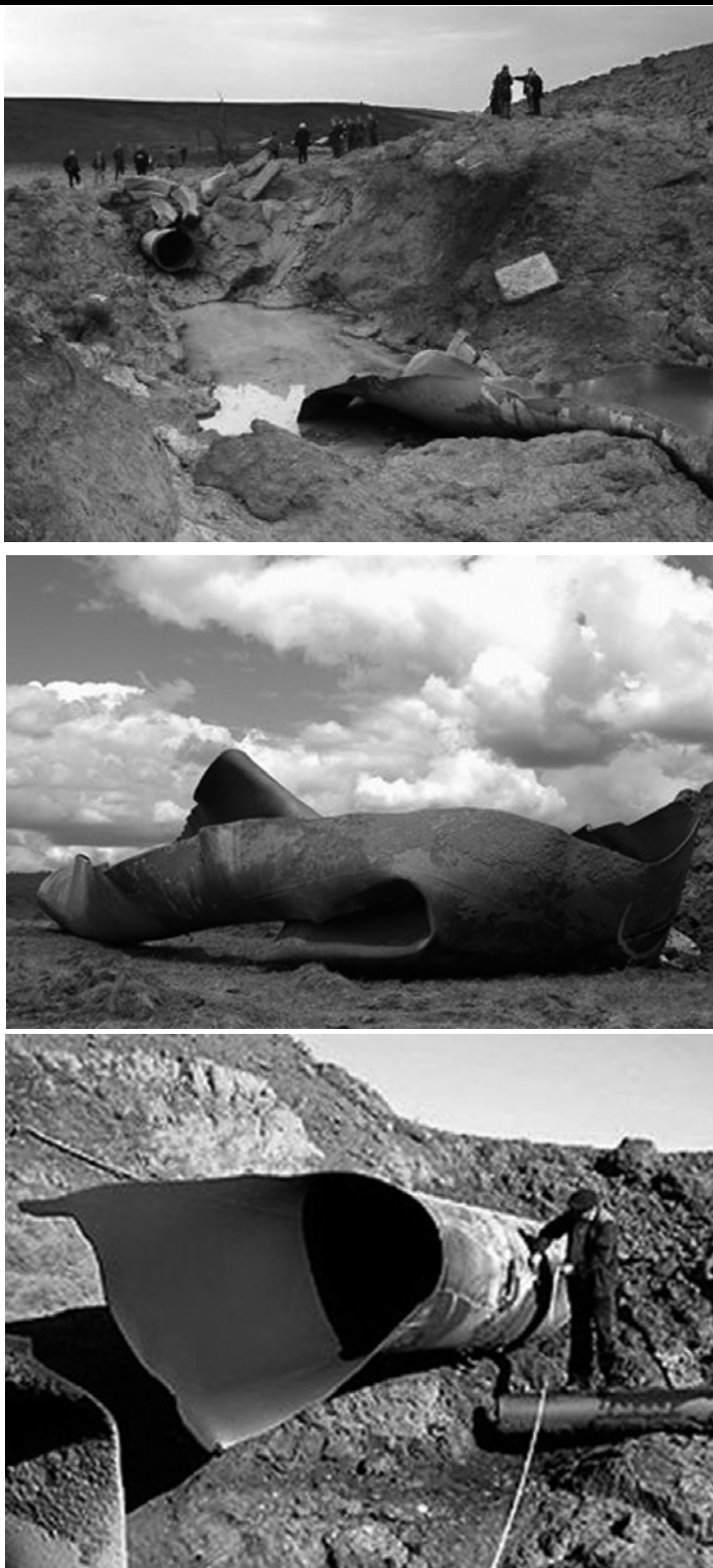
Рис. 3. Наслідки для довкілля від вибуху газу на трубопроводі
